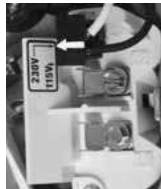
Figure 4A - Prise de modification de la tension réglée sur le 230 V
